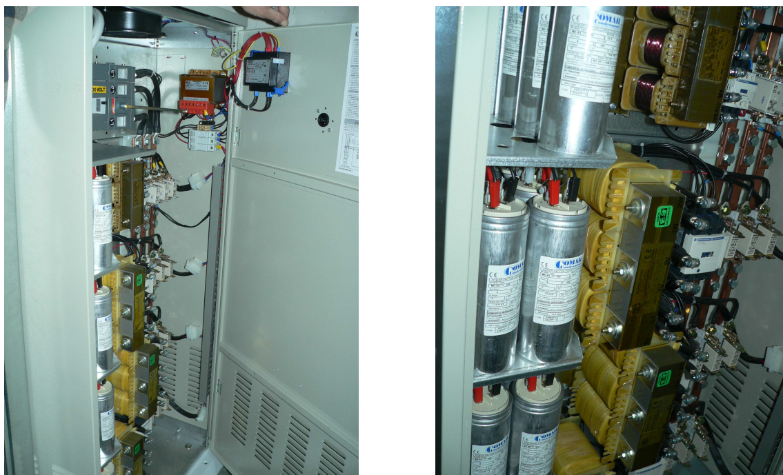
Figura 26 - Particolare del rifasatore: a destra sono ben visibili le induttanze di sbarramento
